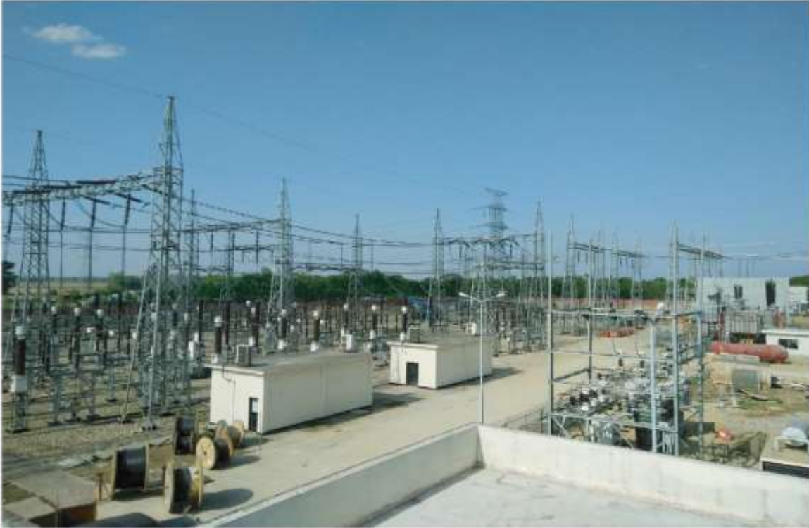
নবনির্মিত বিবিয়ানা ৪০০/২৩০ কেভি গ্রীড সাবস্টেশন
