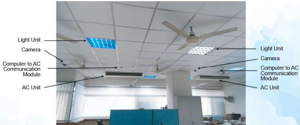
বিইপিআরসি'র অর্থায়নে তৈরিকৃত Building Energy Management System Lab (BEMS Lab)
