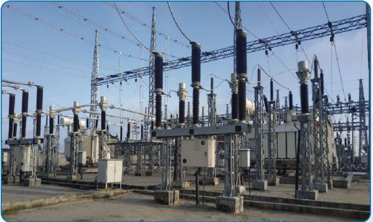
রাজবাড়ি ১৩২ কেভি সাবস্টেশন
